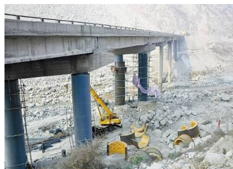
图2 桥墩受冲击导致结构受损但交通功能维持
