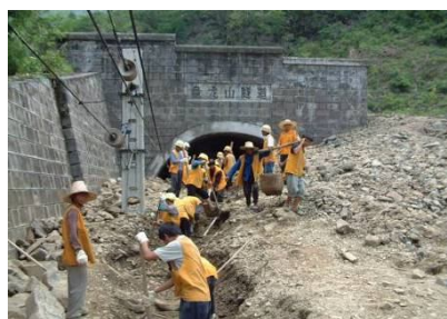
图1 隧道被淤堵后使用功能完全丧失
